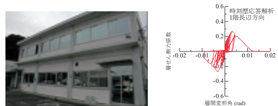
図 4. 大破した建物の地震応答解析：ブロック造の垂壁・腰壁による柱内法スパンへの影響を適切に考慮することで、実被害と対応する解析結果が得られる。
