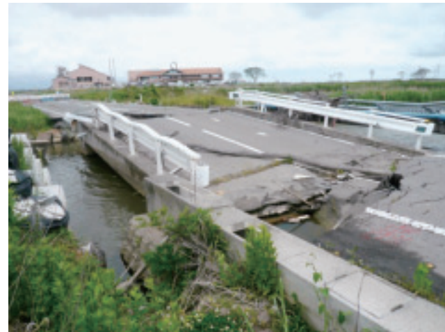
写真1 津波作用による道路構造物の被害 (宮城県山元町周辺の被害)
