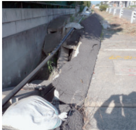
写真2 潮来市の下水道管渠の被害
