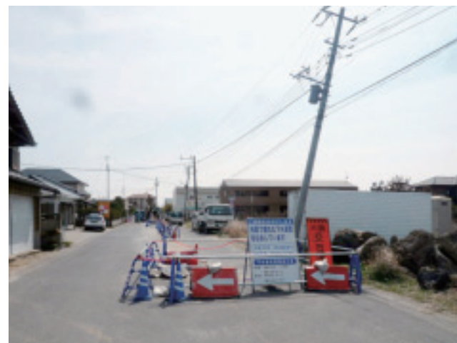
写真2 下水道、電柱の液状化による被害 (茨城県神栖市)
