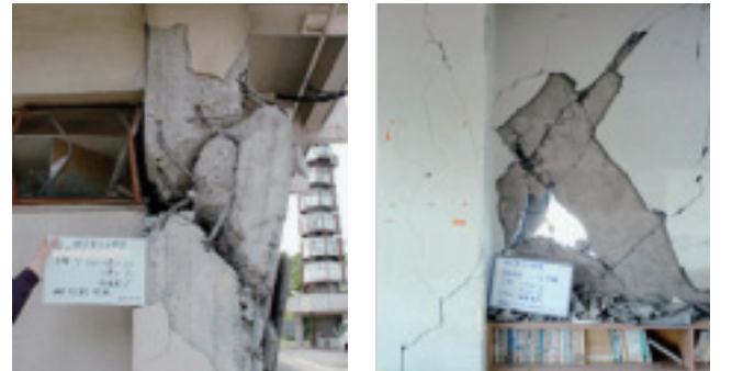
写真3 公共建物の地震被害 左は市役所庁舎の損傷度の大きい柱、右は中学校校舎の壁の被害。
